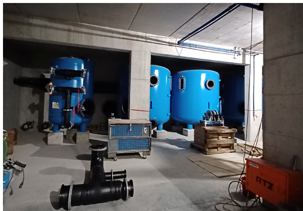
Bildunterschrift Bild 2: Teil der modernen Infrastruktur: Badewasserfilter im neuen Technikkeller des Inselbads (Foto: Stadtwerke Landsberg KU, zum Abdruck frei)
