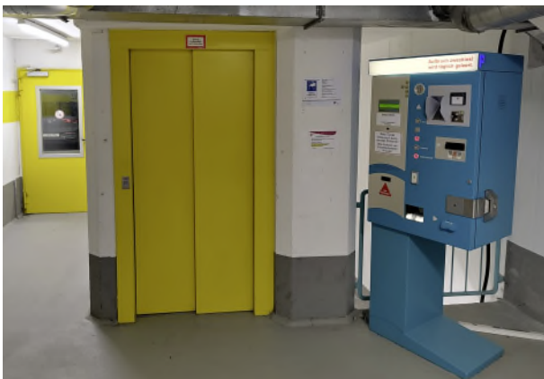
Bildunterschrift Bild 2: Im zweiten Schritt modernisieren die Stadtwerke Landsberg KU den inneren Aufzug 1 am Ausgang Schlossberg in der Parkgarage Schlossberg. (Foto: Stadtwerke Landsberg KU, zum Abdruck frei)
