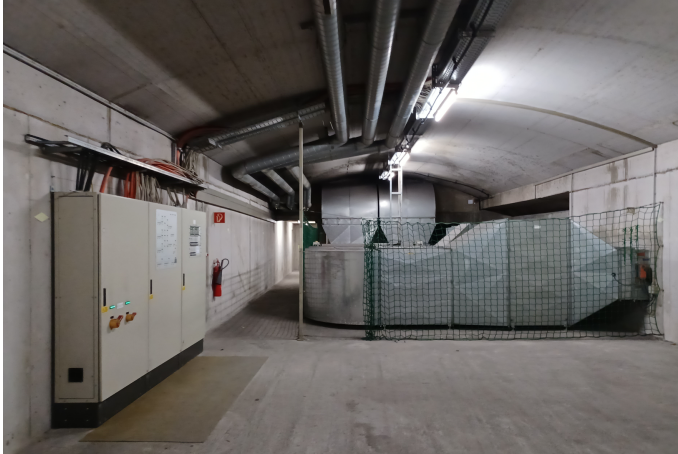
Bildunterschrift Bild 1: Die Steuerung der Abluftanlage in der Parkgarage Schloßberg der Stadtwerke Landsberg KU. (Foto: Stadtwerke Landsberg KU, zum Abdruck frei)
