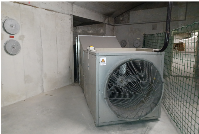
Bildunterschrift Bild 2: Die Zuluftanlage Ebene A in der Parkgarage Schloßberg der Stadtwerke Landsberg KU (Foto: Stadtwerke Landsberg KU, zum Abdruck frei)
