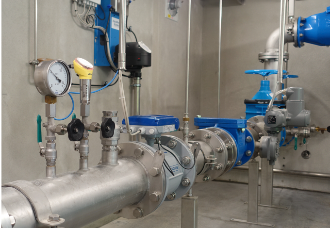
Bildunterschrift Bild 1: Rohrleitungen im Weststadtbrunnen der Stadtwerke Landsberg KU. (Foto: Stadtwerke Landsberg KU, zum Abdruck frei)
