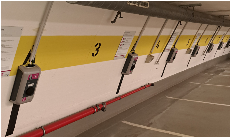
Bildunterschrift Bild 1: Stadtwerke Landsberg KU installieren zehn neue Ladepunkte in der Parkgarage Schlossberg (Foto: Stadtwerke Landsberg KU, zum Abdruck frei)
